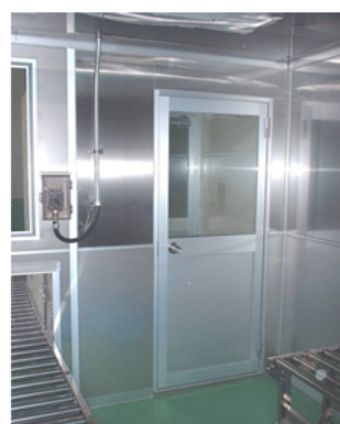
エアシャワー入口側
